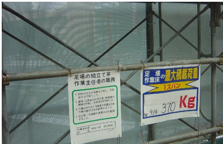
照片 7. 施工架上之載重限制應於明顯易見之處明確標示。
